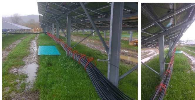
Exemple de câbles aériens sous les modules (source : Urbasolar)
