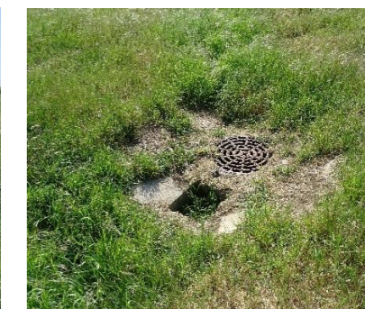
Photo n°2 : Regard localisé dans une noue d'infiltration
