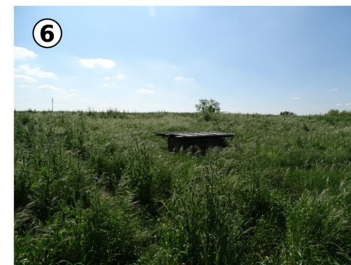
Vue sur un évent de biogaz installé sur la ZIP
