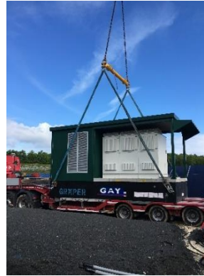
Exemple de livraison d'un poste électrique (source : Urbasolar)
